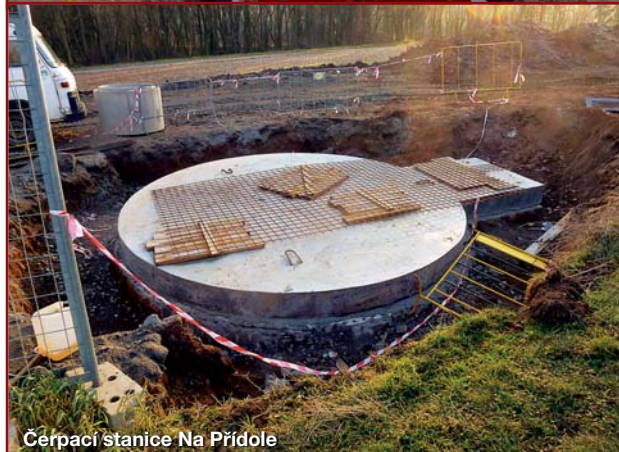
Čerpací stanice Na Přídole
